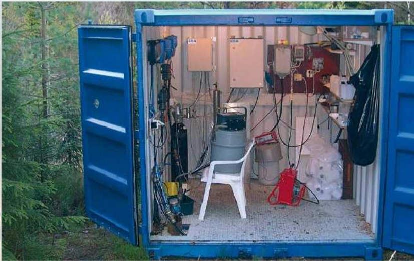
Pumpar och övervakningsutrustning styrs av reglerutrustning i en container.
